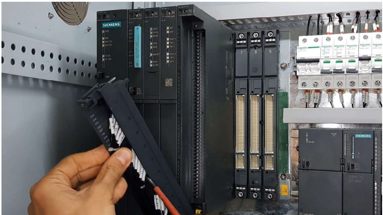
شکل (۴-۲۰) کنترل کننده منطقی Siemens S7400
